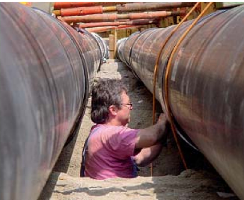
Das Fernwärmenetz des Biomasseheizkraftwerks Sinsheim soll im Endausbau 25 Kilometer betragen und vorwiegend Gewerbekunden mit Heizenergie versorgen. Foto: GEF
